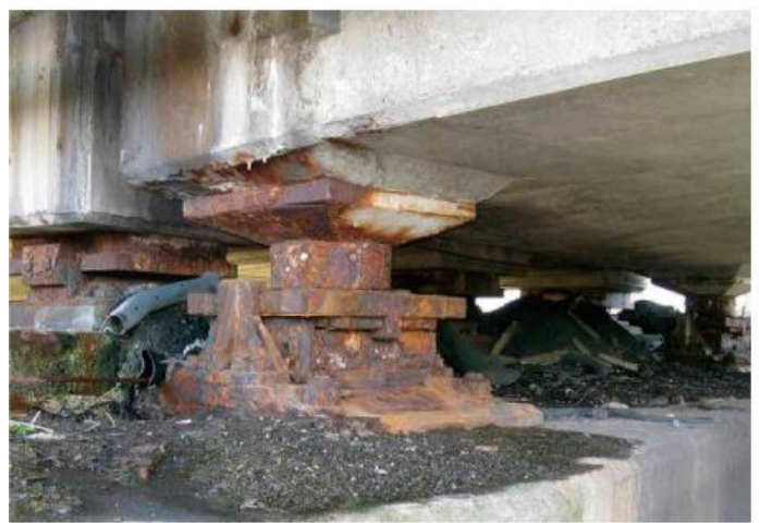
漏水による沓座の腐食
