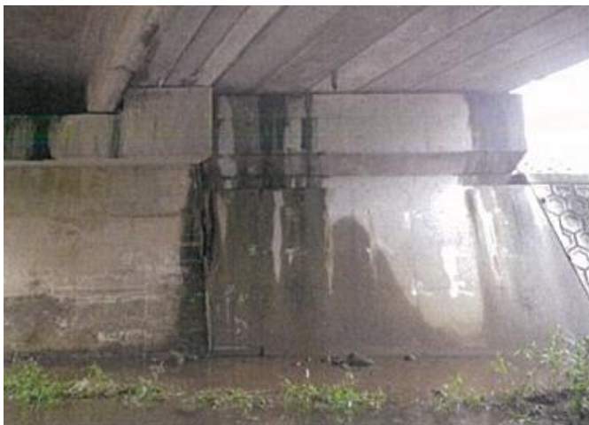
アバットへ漏水している コンクリートの劣化に繋がる
